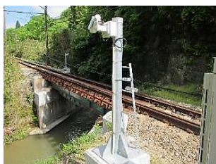
河川増水状況の監視カメラ
